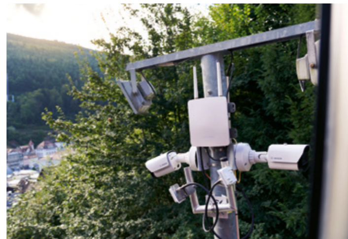
Videobasierte Brandmelder entlang der Bahnschienen
